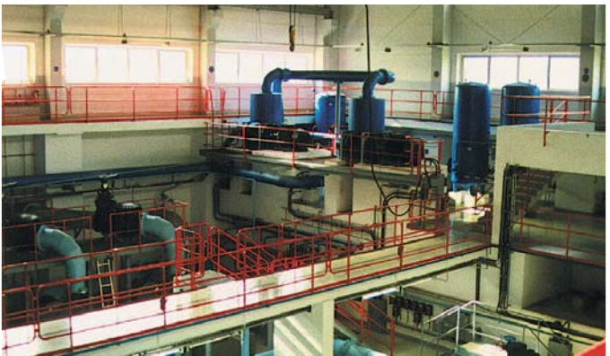
Maschinenhalle des Wasserwerkes Hosterwitz
