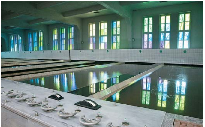
Blick in die Filterhalle des Wasserwerkes Coschütz
