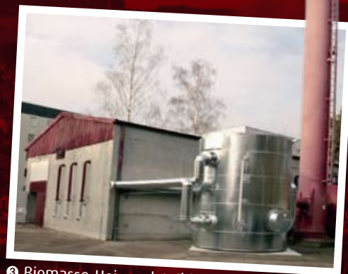
3 Biomasse-Heizwerk Wilder Mann Kalkreuther Straße 52
